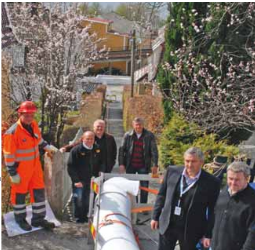
En sterk trio med mange oppdrag for Bergen kommune. Fra venstre operatør Ari Gudmundson fra Olimb, driftssjef hos Olimb, Bjørn Mathisen, fagsjef VA Jonny Vindenes i Vitek, prosjektleder Andres Lunde i Fyllingen Maskin AS, daglig leder Ole Kårtveit i Vitek, og ingeniør Trym Trovik i Vann- og avløpsetaten i Bergen kommune.
